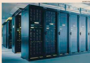
In crescita. Cloud e data center sono fra i segmenti più dinamici del mercato digitale
